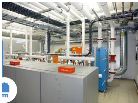
Équipement de géothermique (Clinique Saint Roch)
